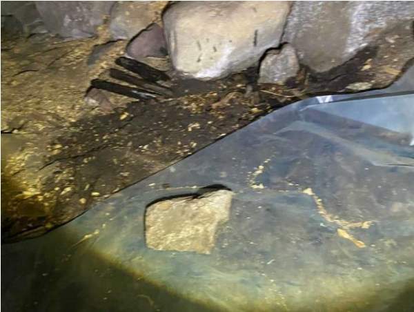
Bild 1: Utvändigt, Krypgrund, Torpargrund Fuktavvisande plastfolie saknas delvis på krypgrundens botten Organisk material noterades på marken i grunden Delar av bjälklaget...
