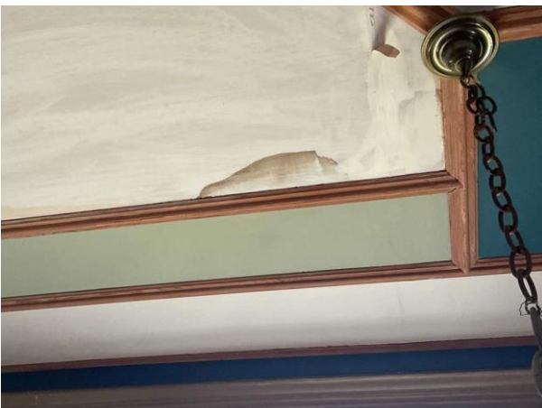
Bild 5: Invändigt, Entréplan, Allrum, Fuktläckor i tak (detta fanns vid förvärvet)
