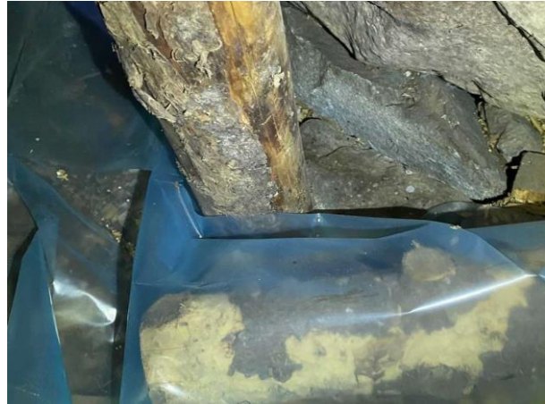
Bild 2: Utvändigt, Krypgrund, Torpargrund Fuktavvisande plastfolie saknas delvis på krypgrundens botten Organisk material noterades på marken i grunden Delar av bjälklaget...
