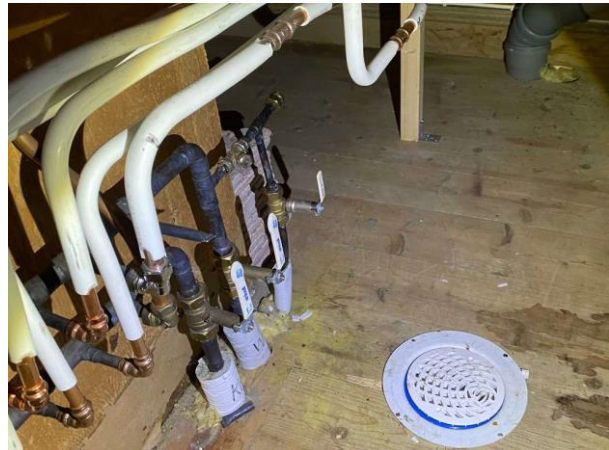
Bild 4: Invändigt, Entréplan, Wc, Inbyggda vattenkopplingar saknar tät botten (golvbrunn finns monterad, dock inget tätskikt på golvet)
