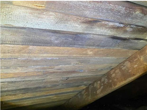
Bild 3: Utvändigt, Vind, Huset är självdragsventilerat Vinden är tilläggsisolerad Lokalt noterades det mikrobiell påväxt på underlagstaket ovanför stora huset Lucka...
