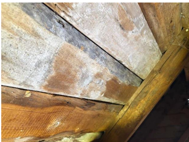
Bild 3: Utvändigt, Vind, Huset är självdragsventilerat Vinden är delvis Parallellisolerade /snedtak (utgår ur besiktningen) Lokalt noterades mikrobiell påväxt på und...
