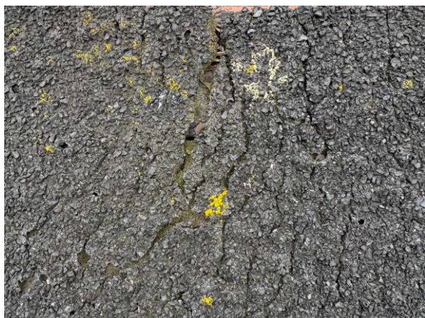
Bild 5: Utvändigt, Yttertak, Äldre tak Sprickor noterades i takpappen Se riskanalys
