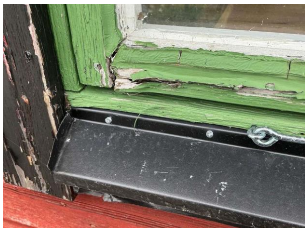
Bild 6: Utvändigt, Fönster, Rötskadat fönster noterades
