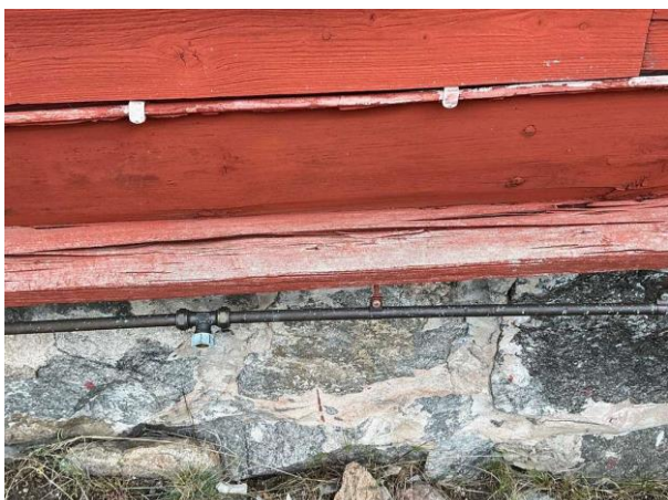
Bild 1: Utvändigt, Fasad, Färgsläpp och torrspäckor noterades i panelen Offerbrådan är sliten
