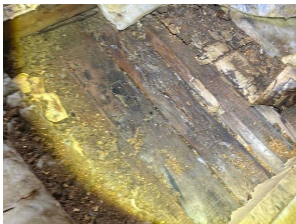
Bild 4: Utvändigt, Vind, Huset är självdragsventilerat Vinden är delvis Parallellisolerade /snedtak (utgår ur besiktningen) Lokalt noterades mikrobiell påväxt på und...
