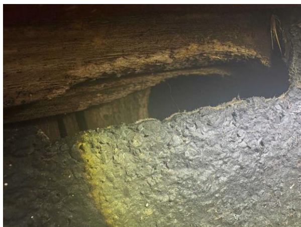
Bild 2: Utvändigt, Ytterdörr, Tröskelplåt saknas till balkongdörren Otät anslutning noterades vid dörren Se riskanalys
